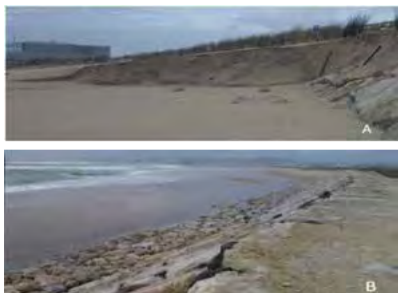
Fig. 8. SJC em 06/03/2018 – zona sul (perspetiva para N): A, escarpamento da berma no encosto entre a defesa aderente e a duna; B, erosão muito significativa do areal com exposição do sopé da defesa aderente.
