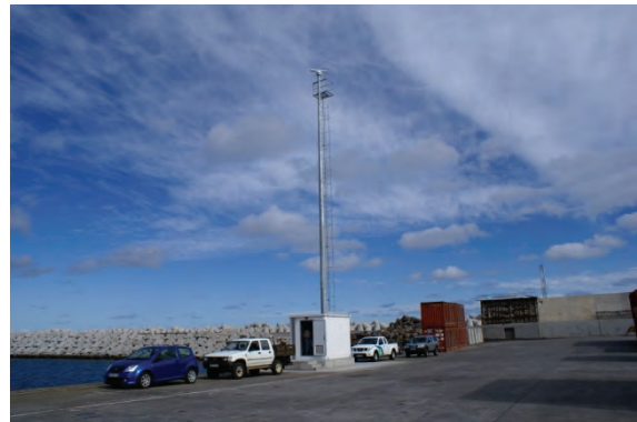
Figura 4 – Torre e instalações do radar de banda X no porto da Praia da Vitória para a monitorização da agitação marítima periférica.
