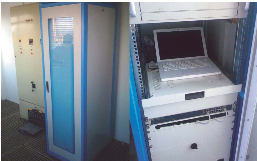
Fig. 4 – Equipamento Tx, Rx e processamento associado
