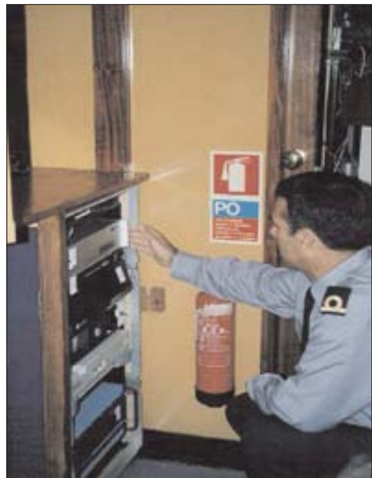
Montagem dos equipamentos do EM 3000 em rack de 19" na UAM «Atlanta»
